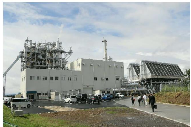
豊後大野市三重町のエフオン豊後大野発電所 左奥のボイラーで木質チップを燃やし、発生した蒸気を左手前・中央のタービン・発電機建屋に送って発電。右の復水器で蒸気を冷やして水に戻す。
