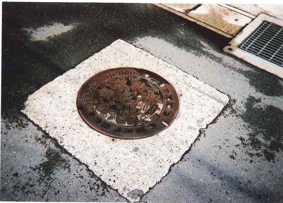
写真-1 マンホール
